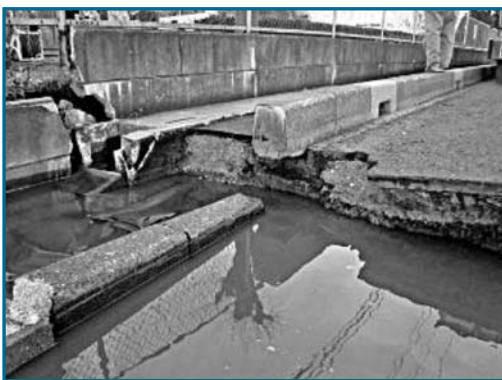
▲段差ができて寸断された道路(右上には、立ち往生しているトラックドライバーらしき人物が写っている)
